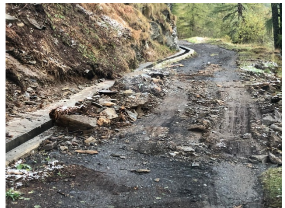
Abbildung 3 Erdrutsch verstopft die Hochwasserschutzrinne 2020
